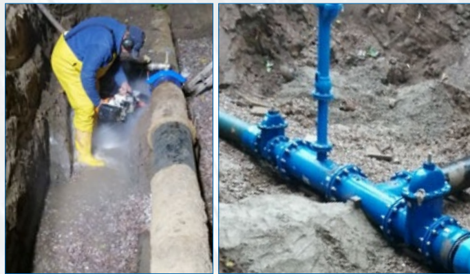
Die Zuleitung vom Hochbehälter wurde am südwestlichsten Ende der Baustelle für den Einbau eines Schieberkreuzes aufgeflex. Fotos: WAG
